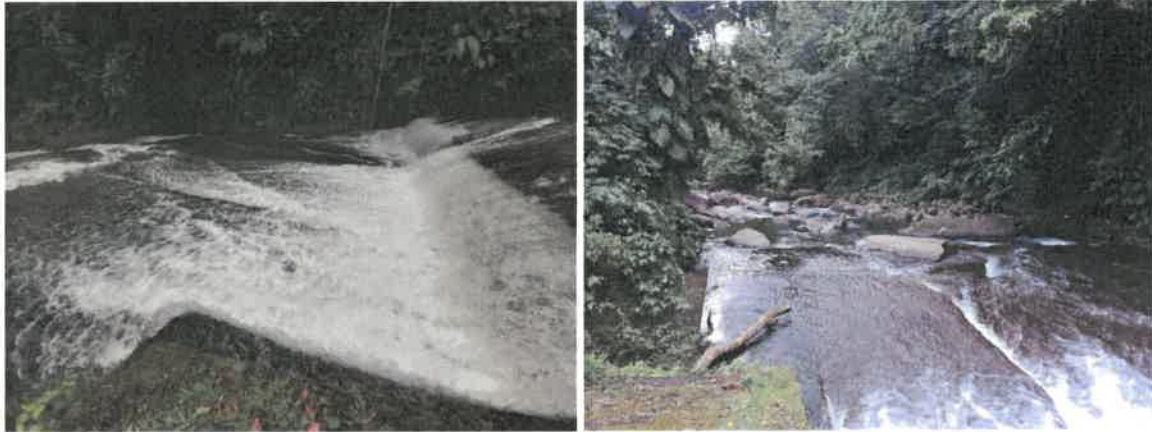
Figure 12 - semelle et marche en béton armé en aval de la prise AEP, future implantation du seuil de l'ouvrage de prise
